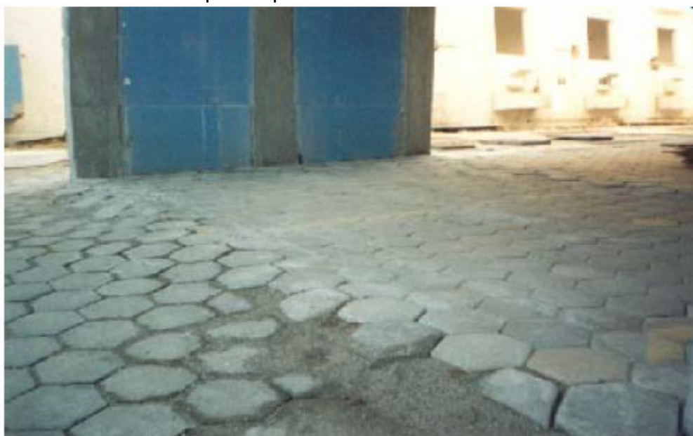
FIGURA 6 – Recalque no piso do estacionamento
