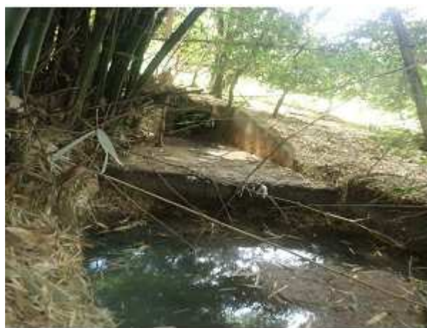
FIGURA 13. Lançamento de água pluvial na nascente, com suspeita de lançamento de efluentes
