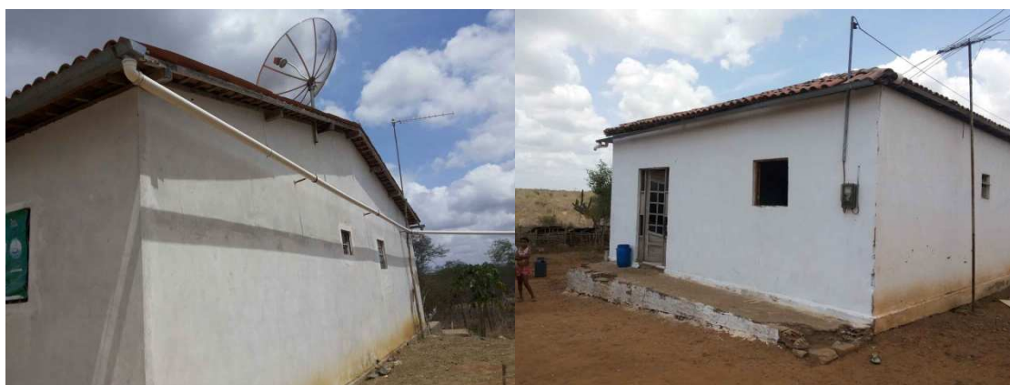
FIGURA 8: Problemas arquitetônicos observados nas residências localizadas no Assentamento Pequeno Richard. Fonte: Arquivo pessoal
