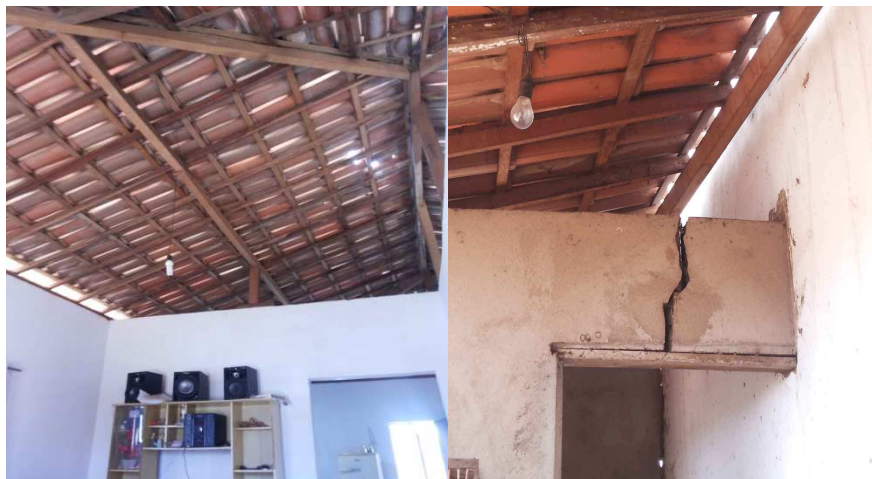
FIGURA 9: Residências localizadas no assentamento Pequeno Richard apresentando ausência de forro e presença de fissuras nas paredes:
