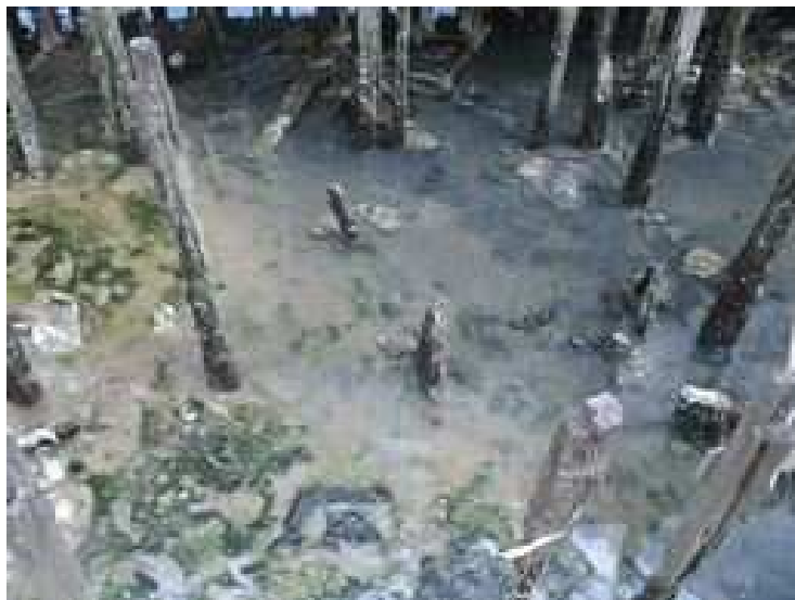
FIGURA 5 - Disposição inadequada dos esgotos domésticos na área não saneada da Vila da Barca.
